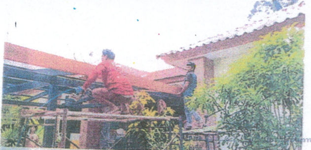
โครงการทอเติมหลังคาทางเดิน ศพ.บ้านห้วยน้ำแก้ว หมู่ที่ ๖
